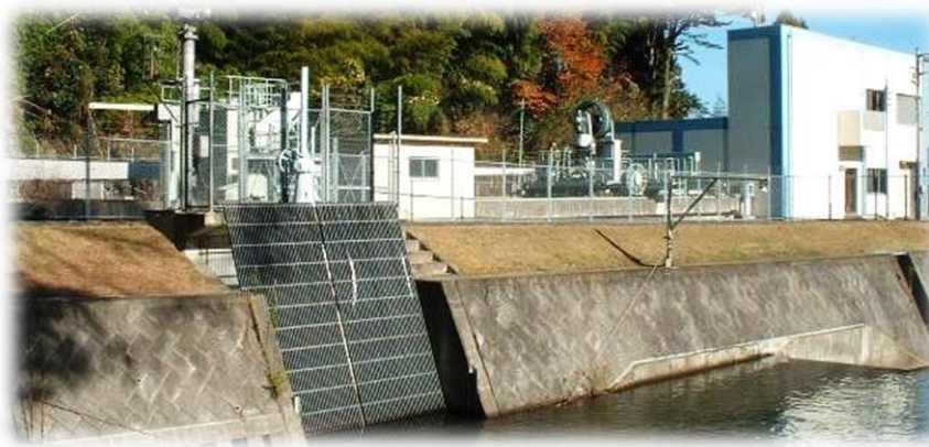
十王川取水口（十王浄水場）
