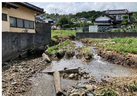
【所沢川(滑川町)】 土砂堆積による河道閉塞
