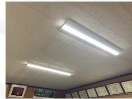
事務所内のLED照明
