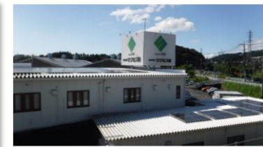
太陽光発電設備の設置状況
