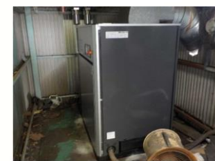
高性能コンプレッサーへの更新
