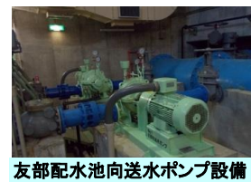
北部配水池向送水ポンプ設備
