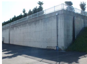
中井山配水場 (森山町)
