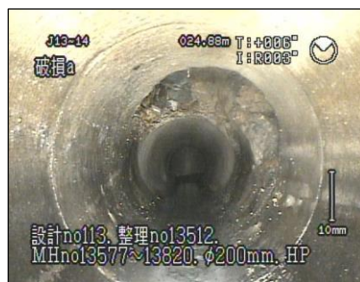
下水道管が破損している状況
