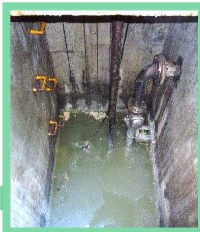
鮎川第3ミニポンプ場
