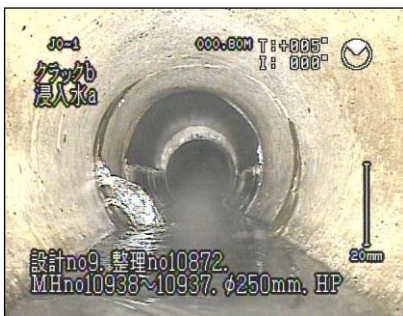
下水道管の外側から内側に水が入ってきている状況
