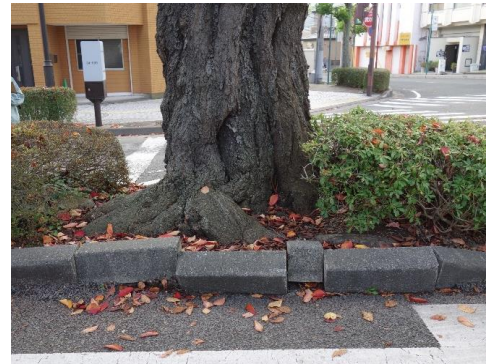
根による植樹帯ブロックの破損
