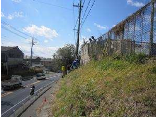
(国道に傾く壁)
