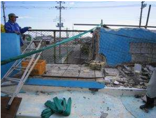
(余震で内側に倒れた壁)
