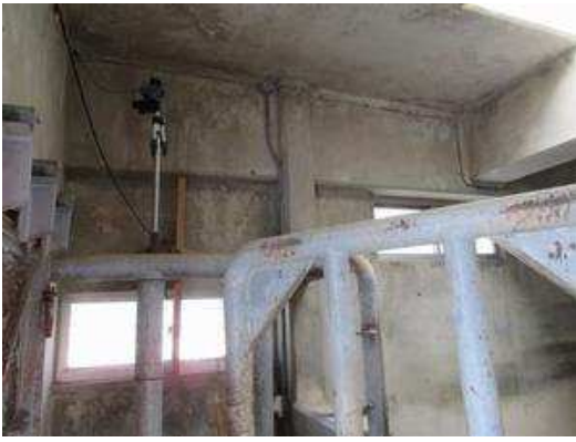
<部屋上部に暗視カメラを設置>
