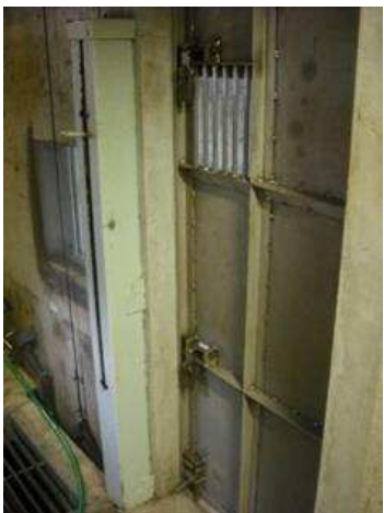
扉は3重ロック
