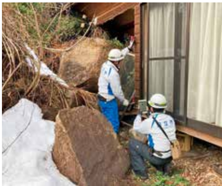
被災した建物の被害認定調査
