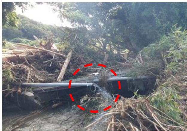
被災後（上流部より）
