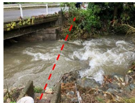
被災後（右岸より）
