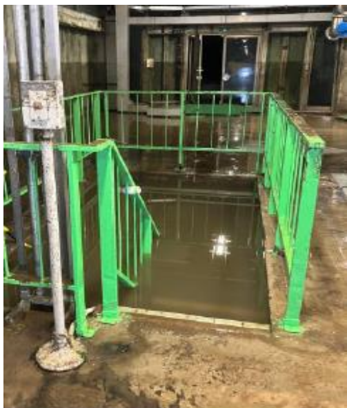
冠水した地下階
