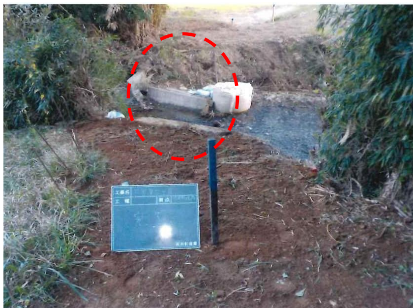
現在の状況（河川横断の配水管折損部を取り除いている。）
