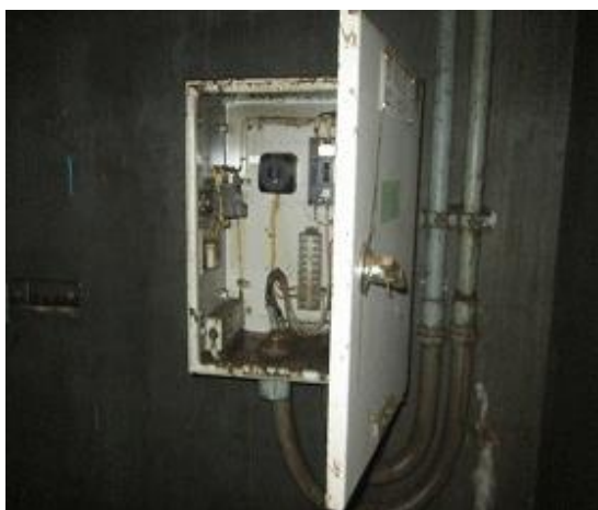
滑川中継ポンプ場
