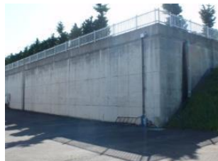
中 井 山 配 水 場 (森山町)
