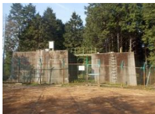
中 井 山 ポ ン プ 場 (森山町3丁目)
