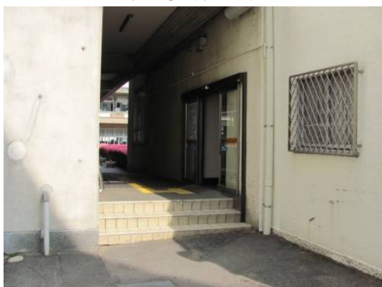
(段差の状況③ (第2・3庁舎間))
