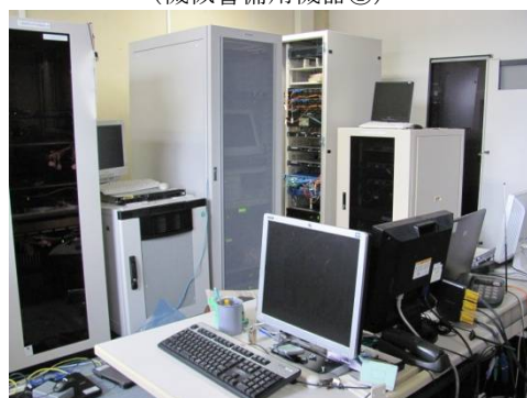
(サーバー室の状況①)
