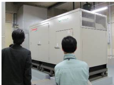
（自家発電装置）
