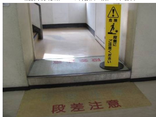
(段差の状況② (第5庁舎))
