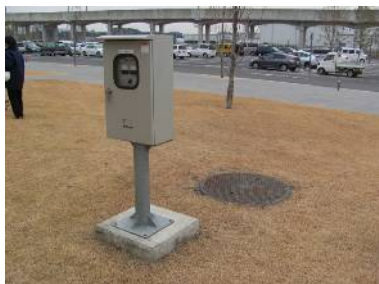
（井戸ポンプ設備）
