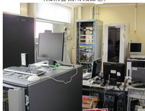
(サーバー室の状況②)
