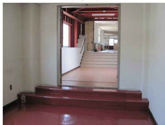
(段差の状況④ (第3・4庁舎間通路))
