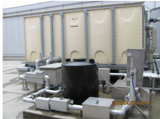
(雨水を利用するための貯留槽 (つくば市))
