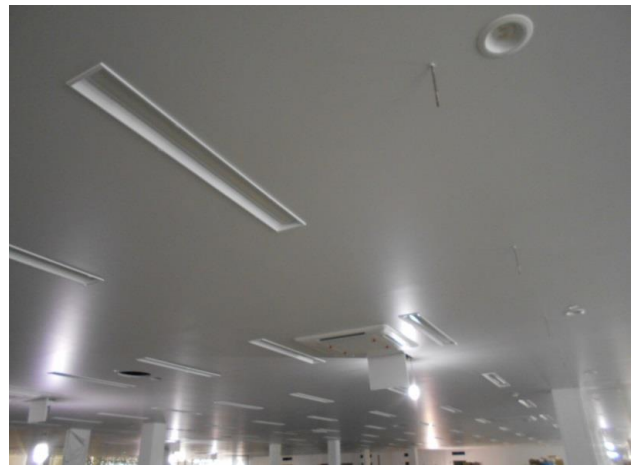
■執務室照明器具の取付け 執務スペースの照明器具を取付けています。照明には省エネに配慮したLEDライトを採用しています。
