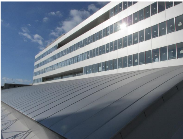
■屋内広場の屋根工事 屋内広場の屋根工事が完了しました。この屋根が第2期工事で建設する大屋根とつながります。
