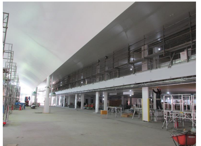
■屋内広場内の様子 屋内広場の天井塗装が完了しました。明るく開放的な空間に仕上がっています。
