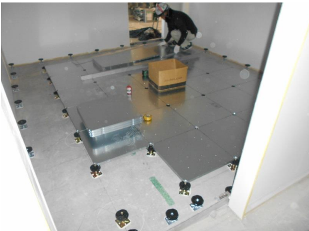
■執務室等床工事 OA機器等の配線を行うため、床下に10cmのスペースを確保した床（OAフロア）になっています。
