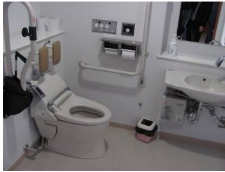
多機能トイレ (立川市)
