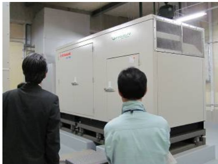
自家発電装置（つくば市）
