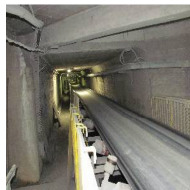
敷地南側の地中を通るベルトコンベア
