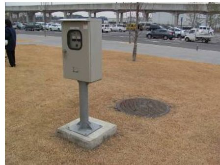
井戸ポンプ設備（つくば市）
