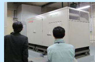
自家発電装置（つくば市）
