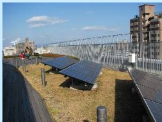
太陽光発電パネル（岩国市）
