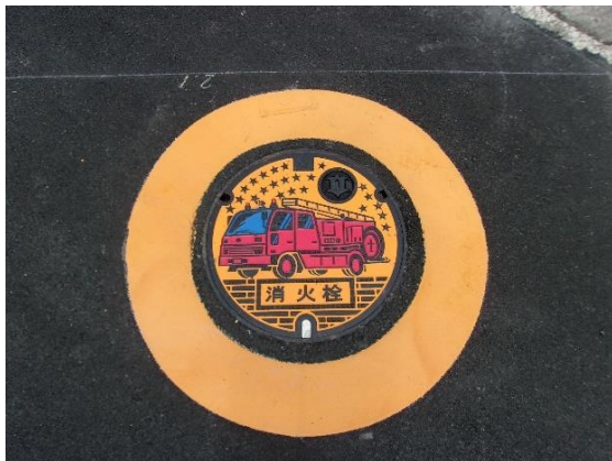
塗色により視認性を高める工夫がされた消火栓
