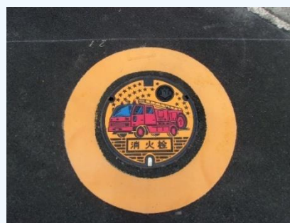
塗色により視認性を高める工夫がされた消火栓
