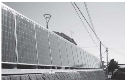
交流センターに設置された太陽光発電設備（中成沢町）
