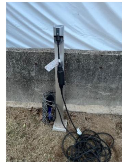
EV車給電設備
