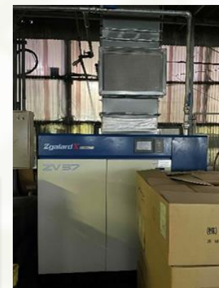
コンプレッサーの排熱利用
