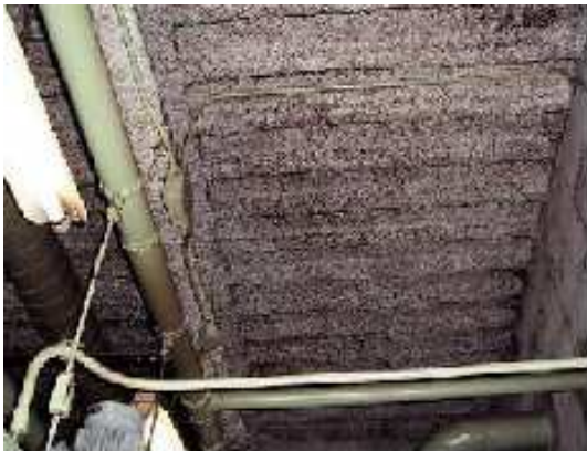
【石綿含有吹付けロックウール】
