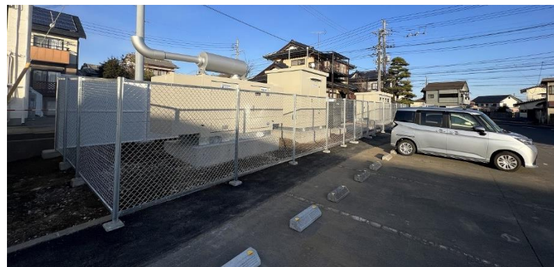
整備した非常用発電設備
