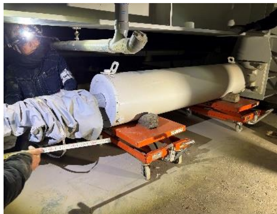
b 免震オイルダンパーの設置状況(地下)
