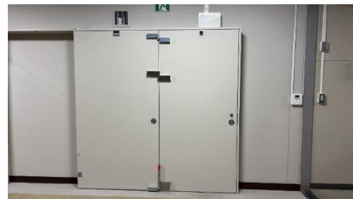
インターロック扉開閉確認
