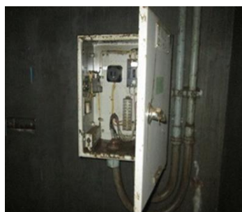
【滑川中継ポンプ場】
