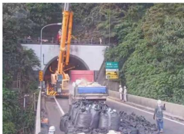
【常磐自動車道下り(鞍掛トンネル付近)】
