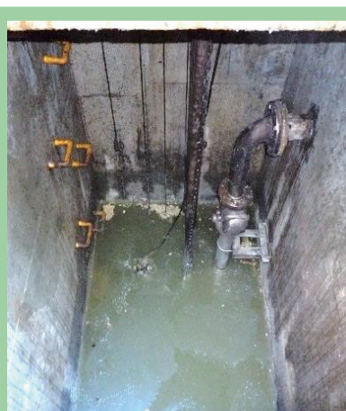
鮎川第3ミニポンプ場
