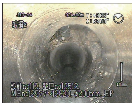
下水道管が破損している状況
