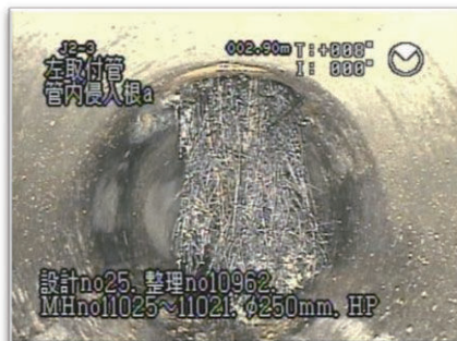
【管内の侵入根】
