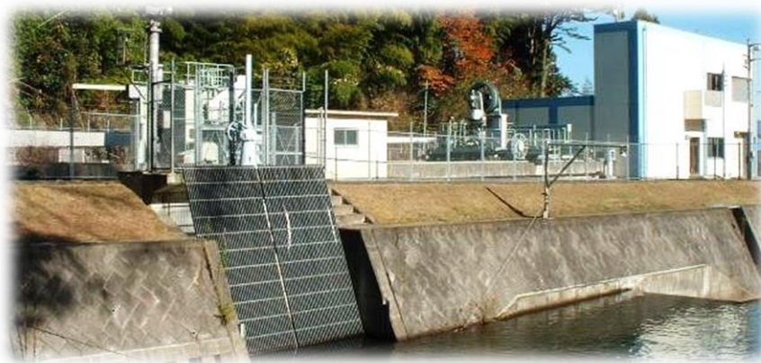
十王川取水口（十王浄水場）
