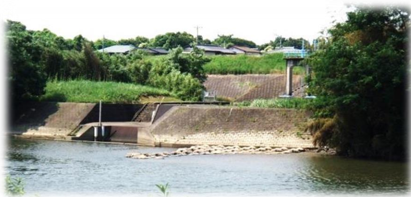
久慈川取水口（森山浄水場）
