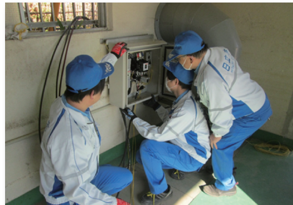
仮設制御盤設置訓練(会瀬ポンプ場)
