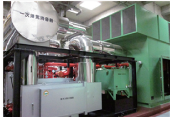
消化ガス発電機
