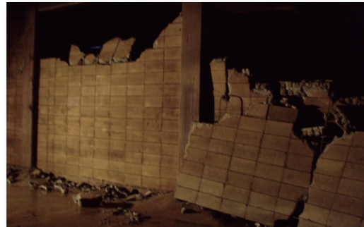
森山浄水場NO.2浄水池整流壁倒壊
