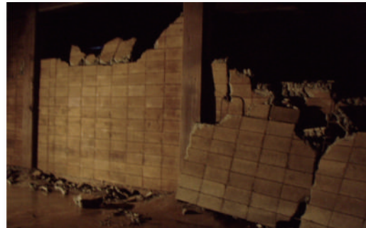
森山浄水場NO.2浄水池整流壁倒壊
