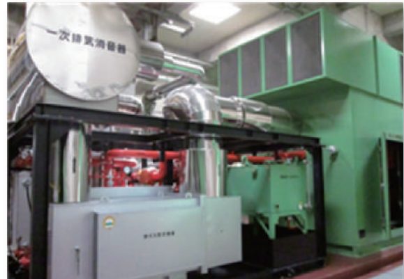
消化ガス発電機
