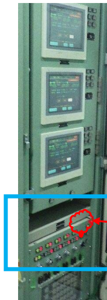
写真 2 制御盤外観写真 (外扉内)
