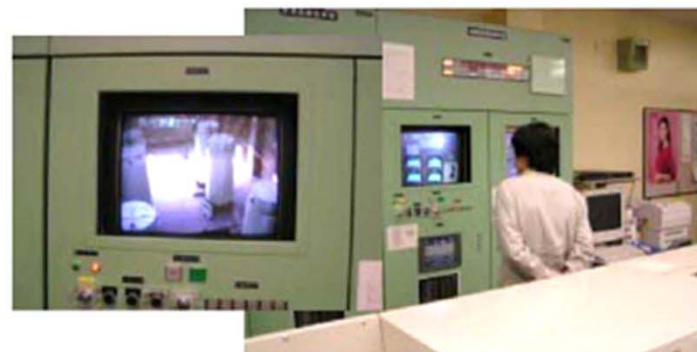
中央制御室 監視盤
