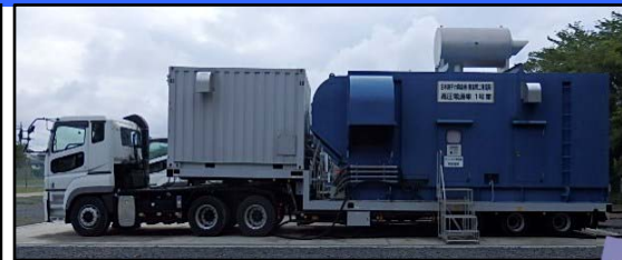
常設代替高圧電源装置 (高圧電源車)
