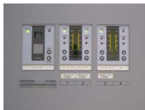
水素濃度計(中央制御室)
