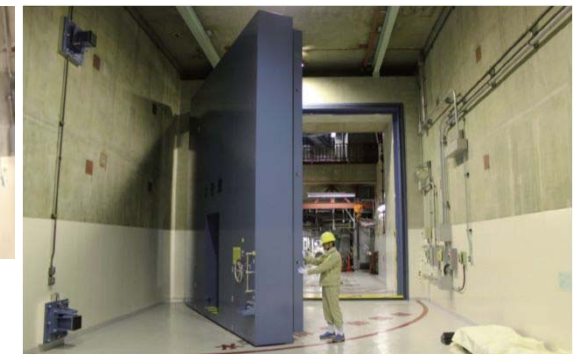
大物搬入口 水密扉 (開放状態)
