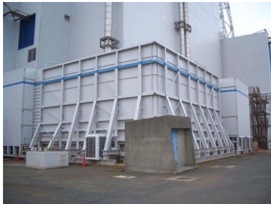
非常用ディーゼル発電機 高さ：8m（海拔16m） 給排気設備防護壁
