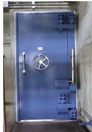
非常用ディーゼル 発電機室入口扉
