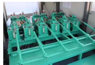
ブローアウトパネル開放用 油圧ユニット
