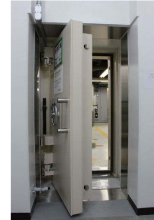
水密扉 (開放状態)
