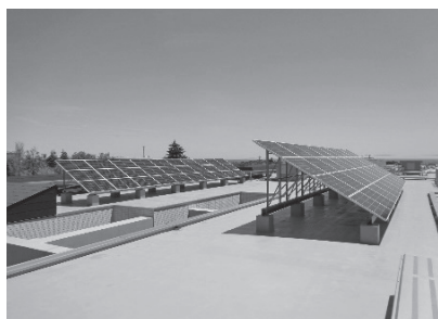
太陽光発電設備
