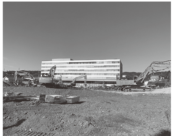
大屋根工事などの第2期工事が進められている市役所新庁舎
