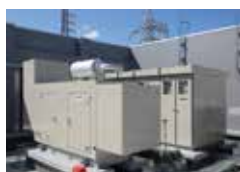
自家発電設備
