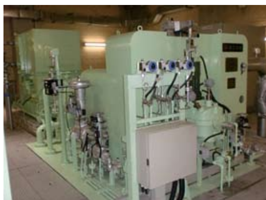
電気設備（蒸気タービン発電機）
