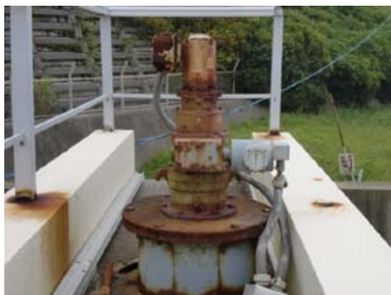
かきよせ 掻寄機の減速機部(処理施設内)
