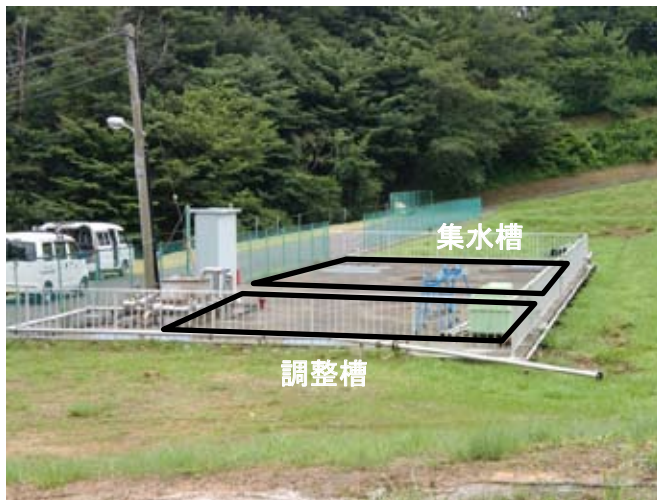
集水槽及び調整槽
