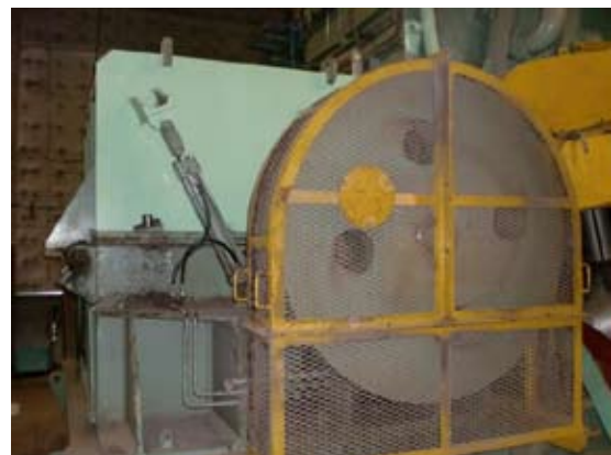
破碎圧縮設備(破碎機)
