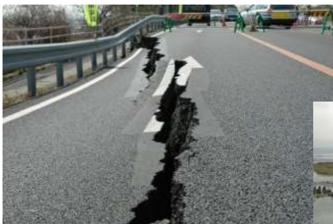
東北地方太平洋沖地震（道路の亀裂）
