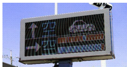
駐車場情報配信システム
