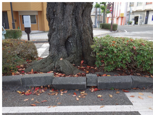
根による植樹帯ブロックの破損
