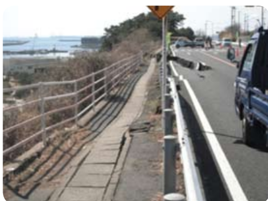
道路の陥没（国道245号）
