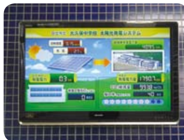
太陽光発電システムの表示パネル
