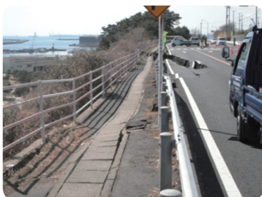
道路の陥没（国道245号）
