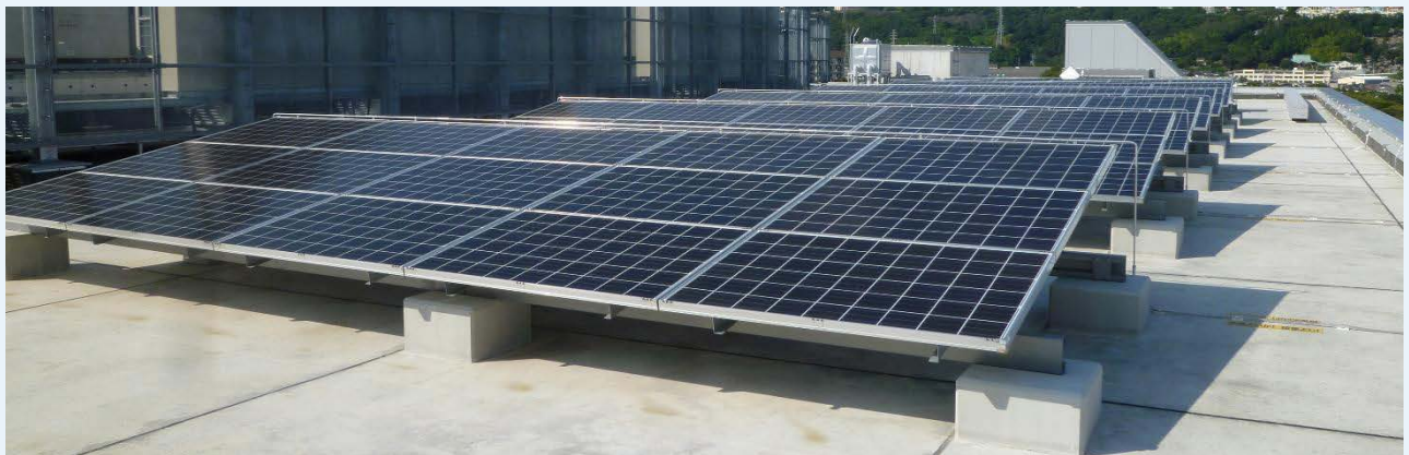
日立市役所屋上にある太陽光パネル
