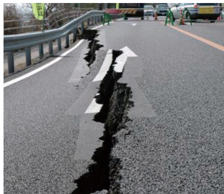
▲道路(国道245号)の損壊(大みか町付近)
