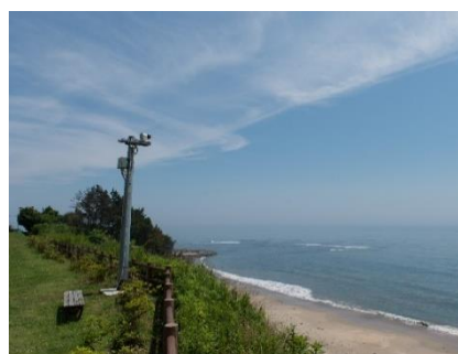
写真－津波監視カメラ
