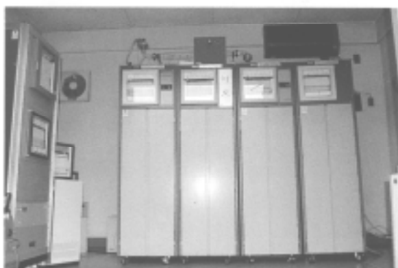
測定局舎内部の自動測定機
