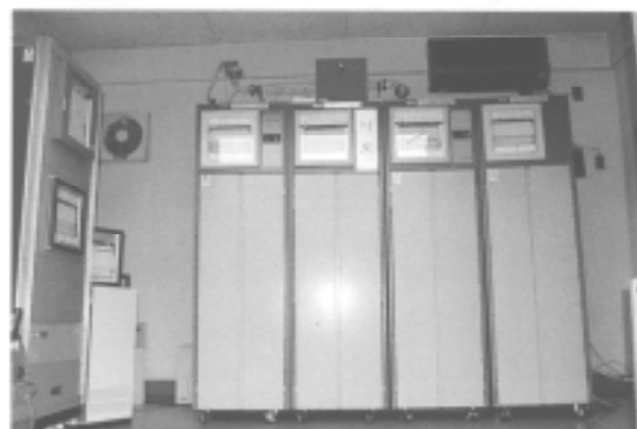
測定局舎内部の自動測定機
